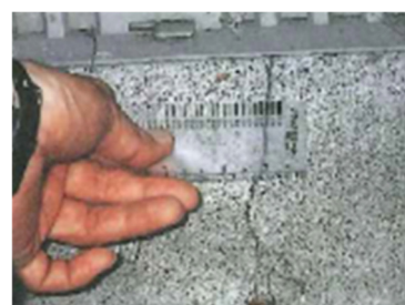
基礎ひび割れの調査
